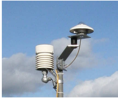
Abbildung 9: Wetterstation auf dem Dach des Bambados
